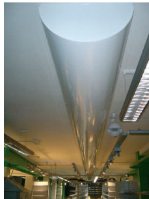
Particolare del punto di vendita e del canale di distribuzione dell'aria.
