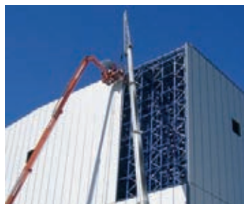
Uno scorcio della struttura realizzata per Orogel
